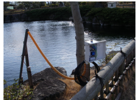
写真 - 1 杖ノ淵公園泉の水位計
