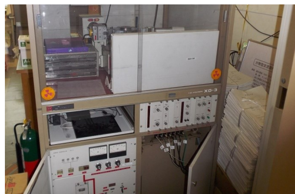
写真 7 島津 X 線回折装置用トランス②
