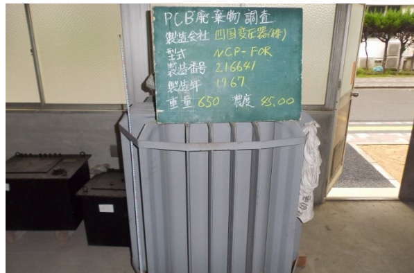
写真 11 低濃度トランスの保管状況
