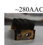
電気接点の金メッキが一部融けてはがれている
